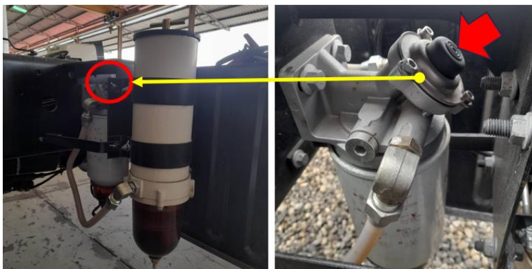
Bomba manual de combustible
