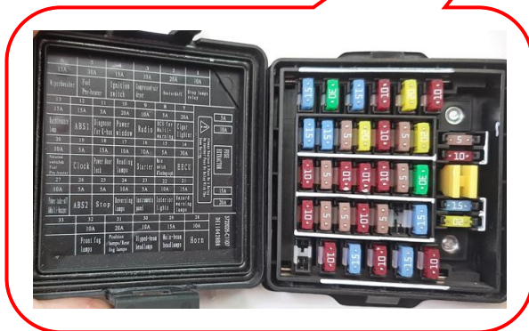
Caja de fusibles
