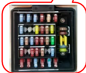
Caja de fusibles
